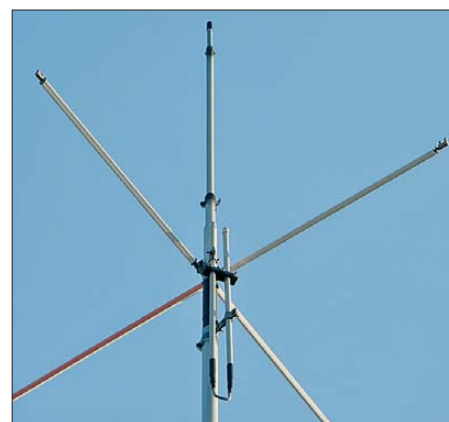
Die vier Antennenstäbe bilden die Dachkapazität der Antenne. Die übergestülpten, leicht drehbaren Kabelkanäle bieten Vögeln keinen Halt mehr. Der Trick lässt sich auch bei anderen Antennen anwenden. Foto: DK4PL
